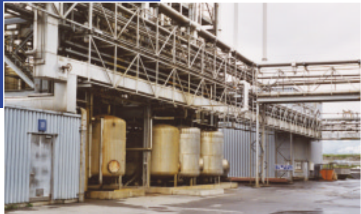
Lagerung fester Tanks
