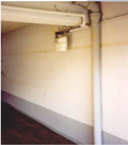
Erhöhte Anordnung Gasversorgung
