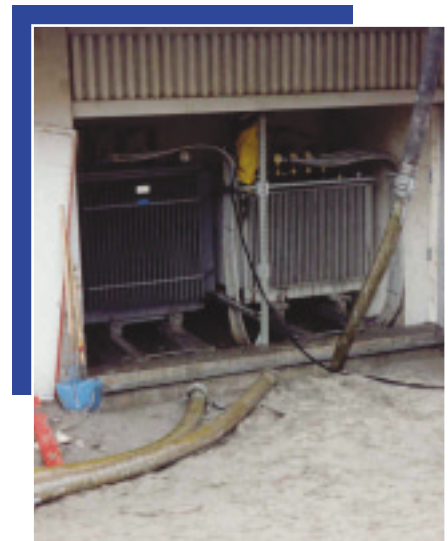
Schaden durch Verschmutzung
