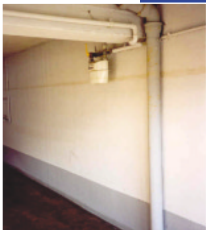
Disposition surélevée de l'équipement d'approvisionnement en gaz
