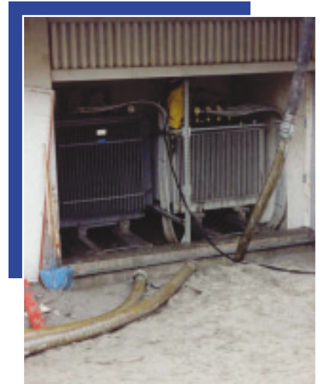
Dommages dus aux salissures
