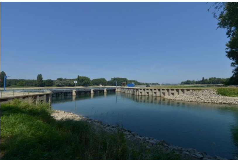
Photo 7 : canal de sortie des eaux de refroidissement de la centrale thermique à vapeur du port rhénan (EnBW) avec râteau, écoulement dans le Rhin vers l'ouest (source LUBW)
